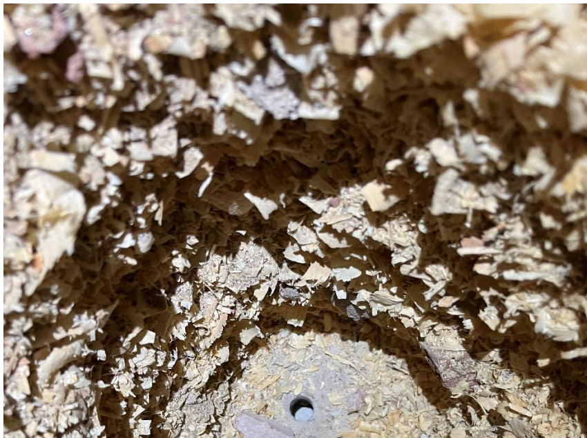
Kuva on yläpohjasta purueristeen yläpinnasta. Betonilaattaan on porattu Ø 16mm reikä rakennekerroksen selvittämiseksi.
